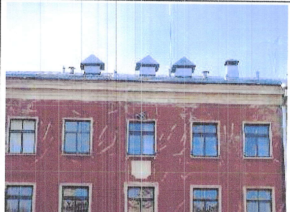
38.att Ventilācijas izvadi
